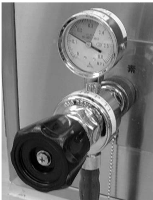
図 1. 酸素アウトレットに接続された圧力調整器
